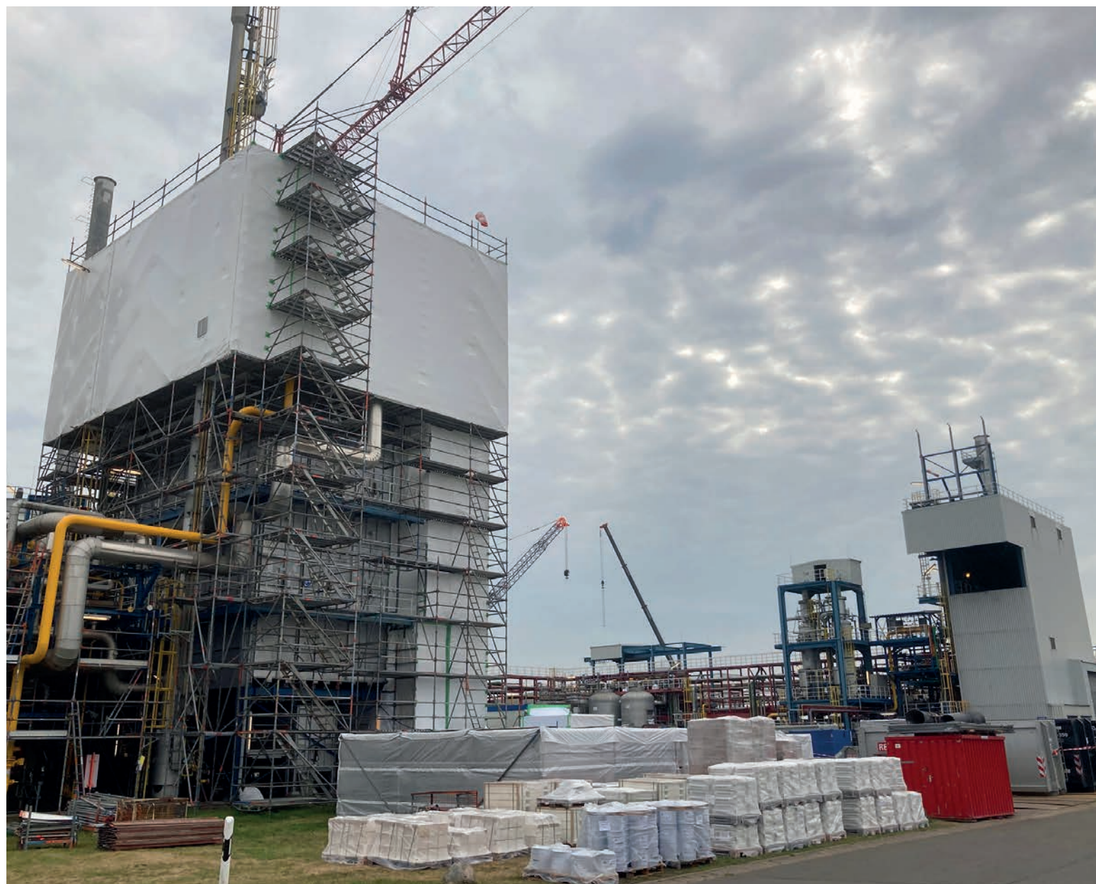
Investition in klimafreundliche Technik bei Covestro in Brunsbüttel: Dampfreformer (links) und Koks-Reformer (rechts). © Covestro
