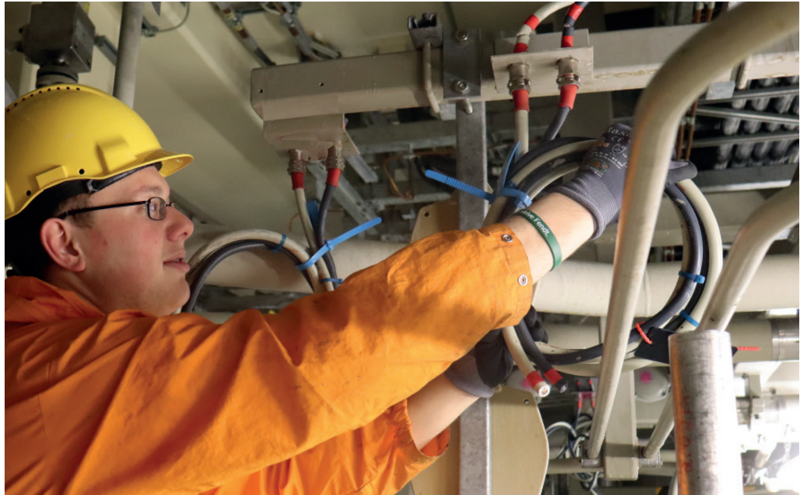
Werkstatt-Mitarbeiter Michel Wilstermann rollt ein Kabelende bis zur Halterung auf, fixiert es und beschriftet es mit dem Aktenkennzeichen. © KBR
